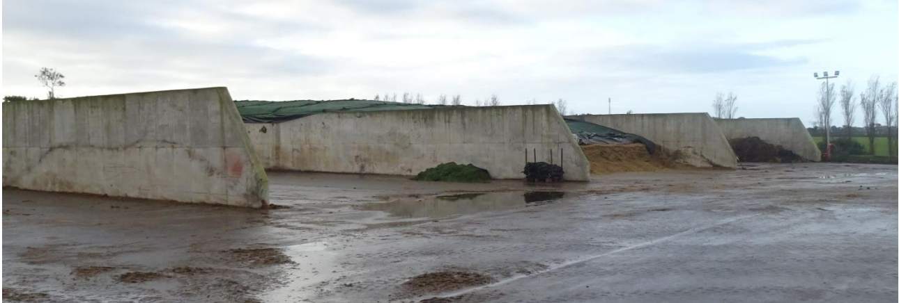
Figure 2 : Silo de stockage déchets végétaux
